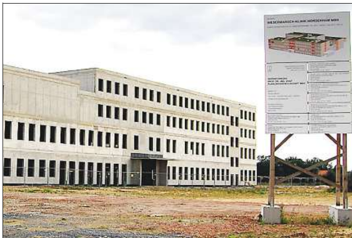
Was aus der Anfang Juni stillgelegten Baustelle der neuen Klinik in Esenshamm wird, bleibt weiter offen.
